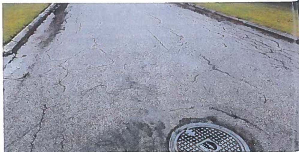
Figur 1. Gamle udtjente belæggninger er ofte fulde af revner og sætninger.
